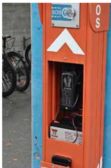
Im Inneren der Notrufsäule finden sich ein Polycom-Funkgerät und eine Strombatterie.
