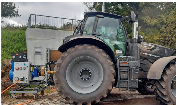
Der von einem Traktor angetriebene Stromgenerator links im Bild ist letzte Woche getestet worden. Im Hintergrund ist das Pumpwerk Reiat beim Hüttenleben zu sehen. Dieses versorgt die Ortsteile des Unteren Reiat mit Wasser. Bild: zvg
