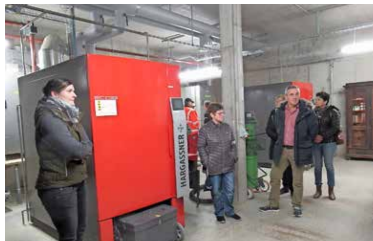
Im Heizungsraum erläutert Betreiber Hanspeter Schalch den Besuchern, wie die Heizung und das Fernwärmesystem funktioniert. Bild: gb
