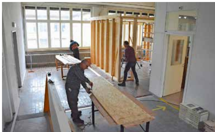
Bauleiter Othmar Naef (vorne) fixiert ein Brett. Derweil arbeitet Martin Tartler (rechts) an der neu aufgebauten Holzständerwand. Bilder: vf
