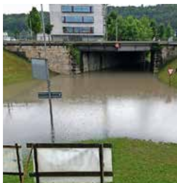
Einmal mehr ist die Bahnunterführung geflutet. Bild: Feuerwehr
