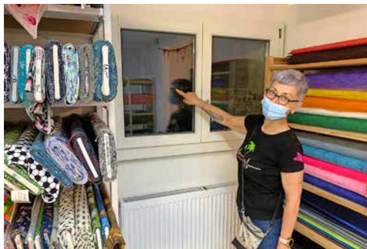
Angela Feliciotti zeigt, wie hoch sich das Wasser im Lichtschacht staute und danach in den Keller sickerte. Bild: vf
