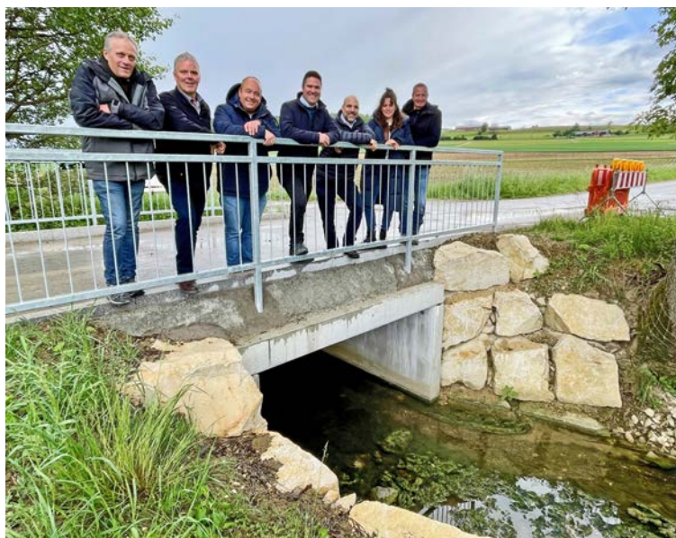
Die Klavbachbrücke ruht auf einer naturbelassenen Sohle. Am Geländer stehen Vertreter der Gemeinden Thayngen und Hilzingen sowie Landwirte und Brückenbauer. Bilder: Gudrun Trautmann
